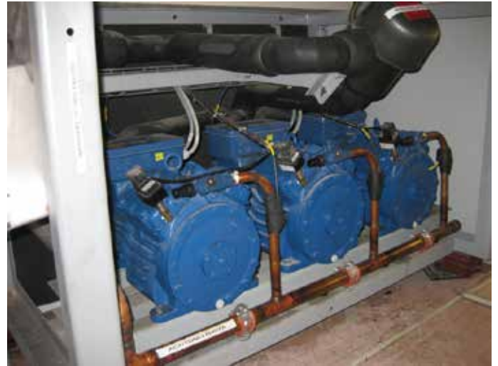
Fig. 2 : Système composé avec 3 compresseurs Bock
